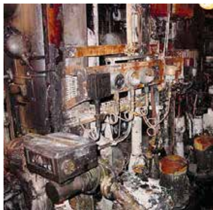
Hjälpmaskinens utsida efter branden.
