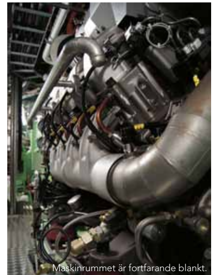
Maskinrummet är fortfarande blankt.
